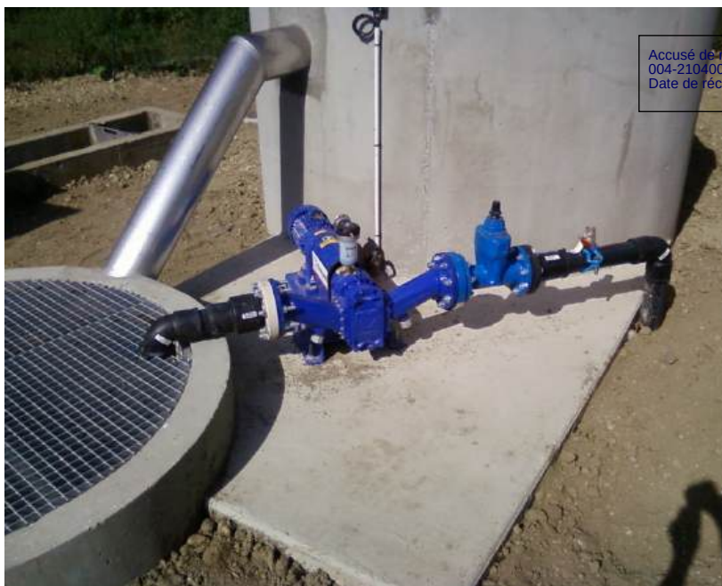
Bâche et pompe à flottant
